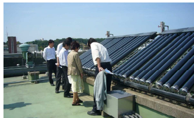
太陽熱温水設備
