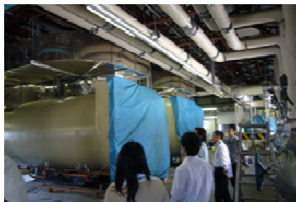
巨大なボイラーの前で説明を聞く参加者
