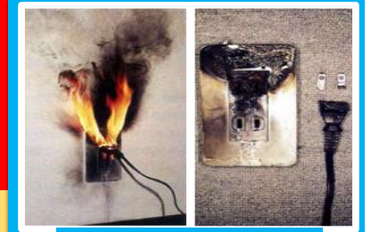
電気火災の事例
